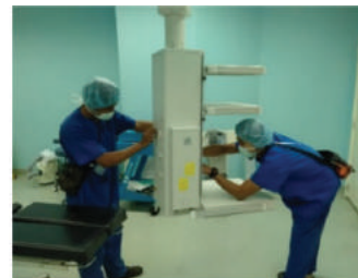
Sistem Gas Perubatan Kompleks Rawatan Harian (ACC), Hospital Sultanah Nur Zahirah, Kuala Terengganu
