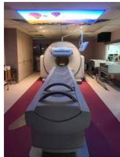
SPECT CT di Hospital Sultanah Aminah
