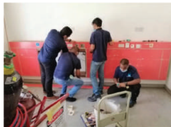
Sistem Gas Perubatan Hospital Hulu Terengganu, Terengganu
