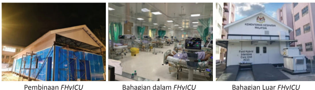
Imej 6.22 Projek FHyICU di Fasiliti KKM
